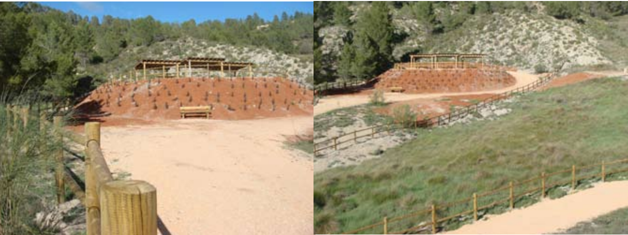
Dos vistas de los trabajos de revegación en El Salobral, Enguïdanos (Cuenca)
